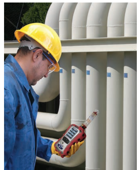
MultiRAE Benzene utilizado para la detección de fugas
